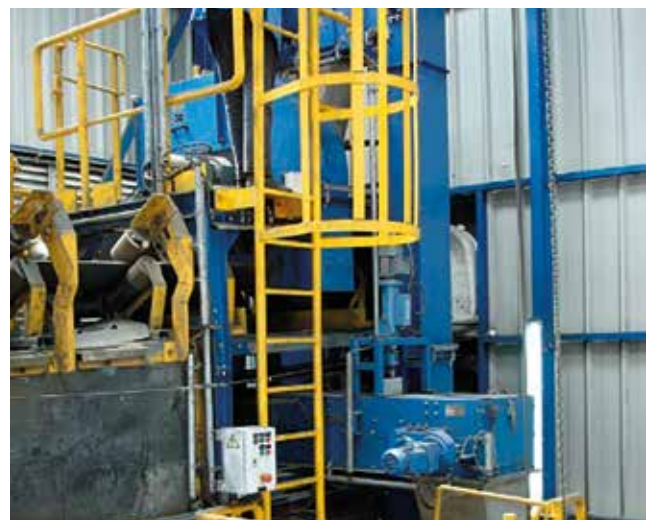
Probenahmeanlage für Kupferkonzentrat
